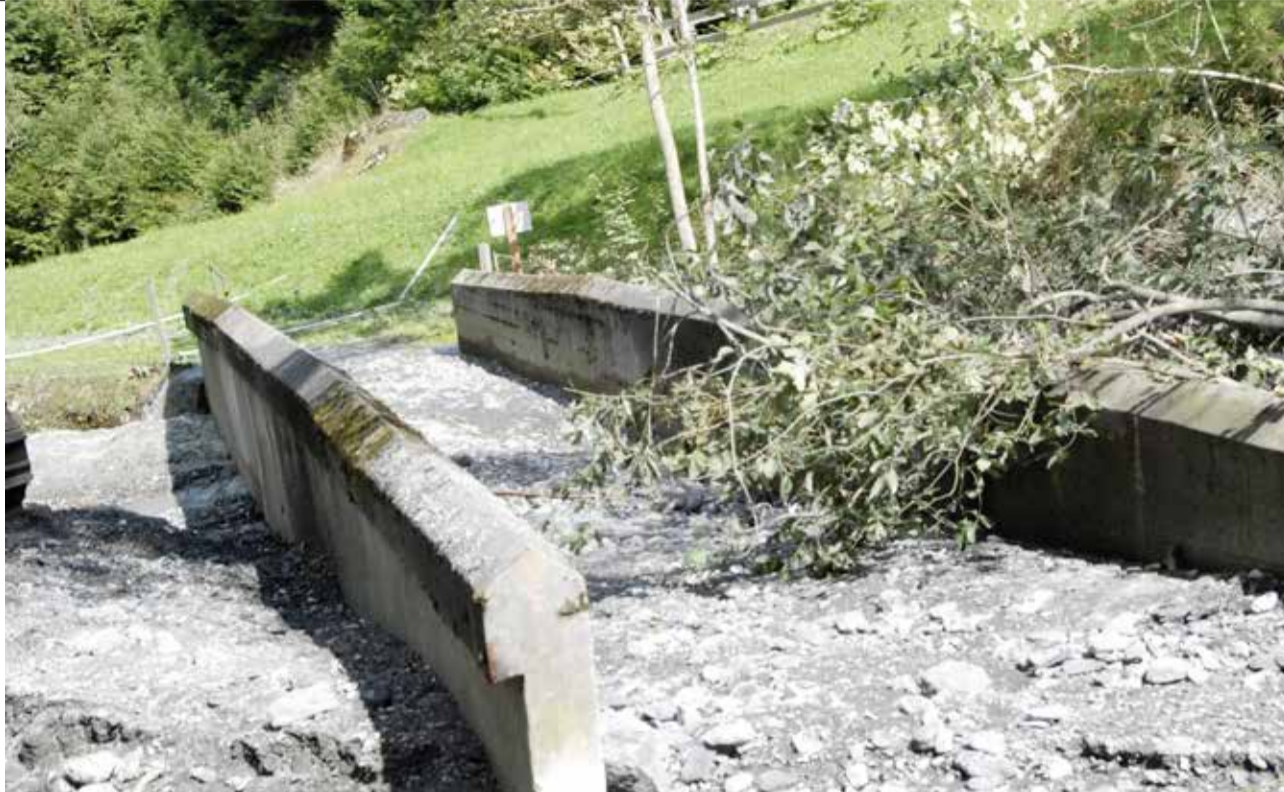
Unpassierbar: Die Brücke oberhalb Weisstannen ist gefüllt mit Geschiebe.
